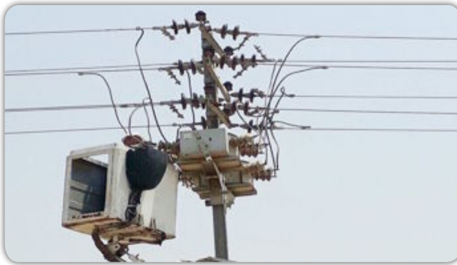
ض.و عدد ٩ ومد اسلاك المنيوم بطول ٤٥٠ متر وضمن فرع توزيع كهرباء مدينة الصدر تضمنت الاعمال رفع التجاوزات ومصادرة المواد وقابلو مبروم بطول ٨٠ متر
